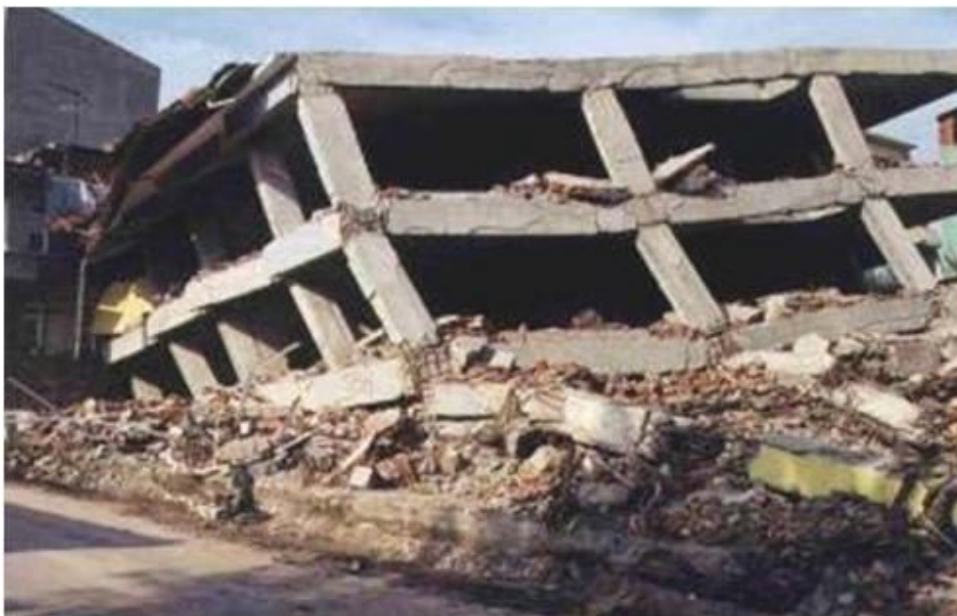
Figura 2 - Estrutura de concreto após abalo sísmico (Rodrigues:2006)
