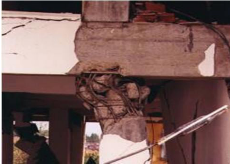
Figura 3 - Estrutura de concreto após abalo sísmico (Rodrigues:2006)
