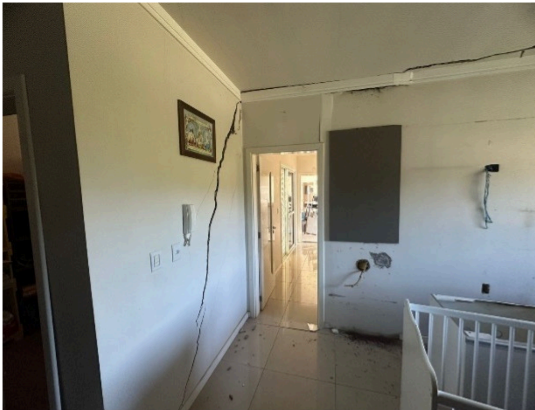
Figura 5 – Fissuras decorrentes de recalque diferencial em edificação atingida
